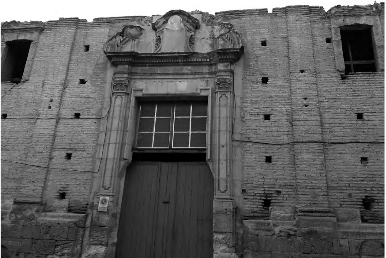
Portada de la iglesia del convento de Mínimos, en lamentable estado de abandono.
